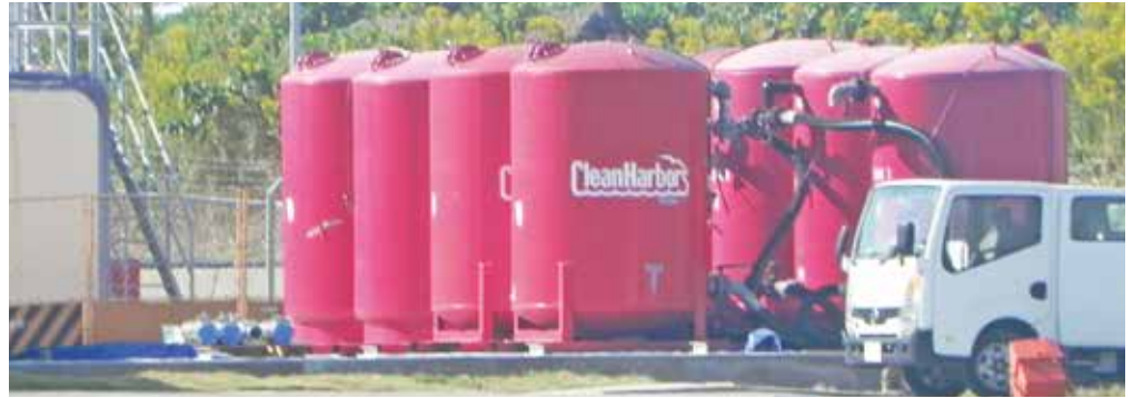
①活性炭フィルター 稼働直前 (2022年10月23日)
