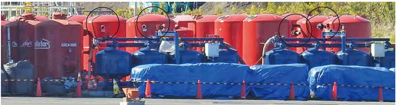
③フィルターからのホースが取り外されていた。ブルーシートはフレコンバッグ。(2023年10月22日)
